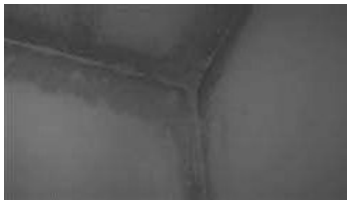
Segni di umidità nel soggiorno.
