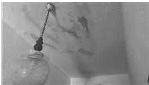
Segni di umidità nel corridoio.
